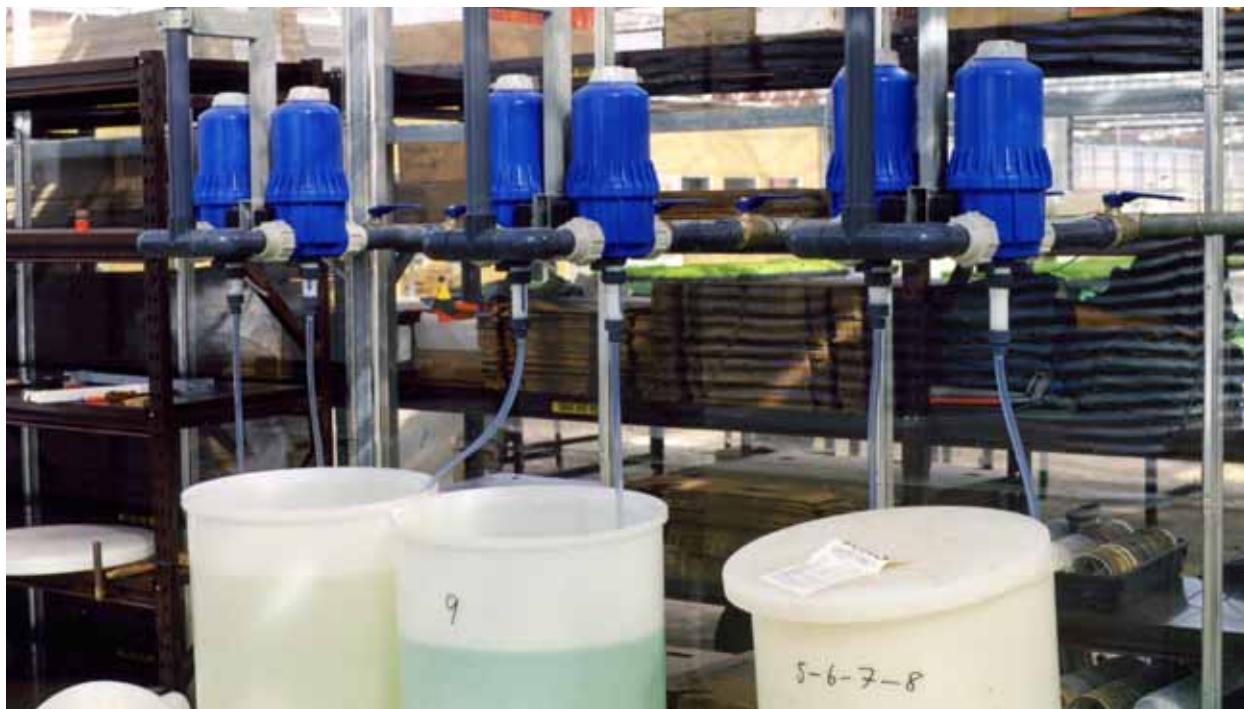
Figur 33. Installation av Dosatron proportionalitetsblandare. Med hjälp av ventiler väljer användaren vilket av de tre paren som ska användas. I varje par är blandarna monterade parallellt med varandra och suger upp olika gödselmedel.
