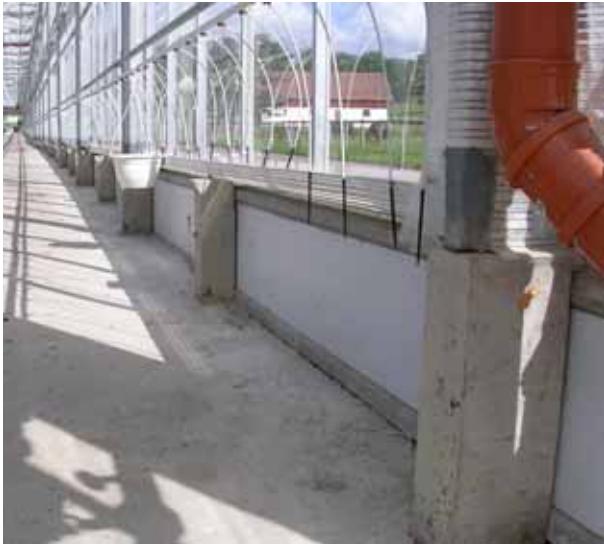
Figur 10. Plintgrund med isolerade sockelelement. Plintarna kan antingen vara färdiggjutna på fabrik och grävas ner, eller så gjuts de på plats.
